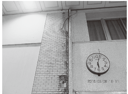
店舗壁破損とクラック
